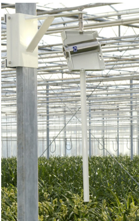
Planttemperatuurcamera in een ophangbeugel geplaatst
